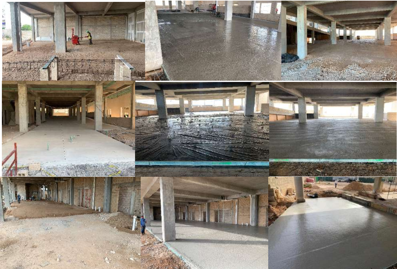
HABILITADO DE ACERO Y COLADO DE FIRMES DE CONCRETO EN EDIFICIO CENTRALIA, MERIDA, YUC.
